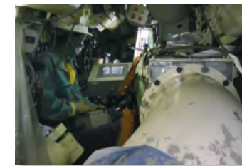
掘進機内状況
