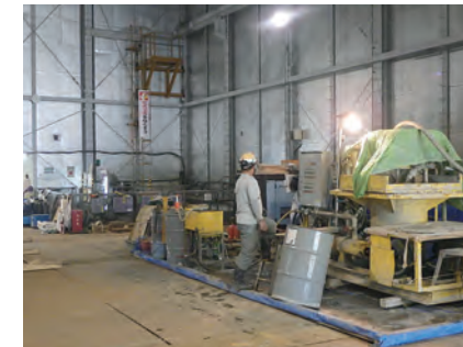
中込充填プラント (ミキサー、アジテータ、気泡発生装置等)
