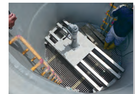
通過立坑内配管 (分岐部、弁室内操作台及び開閉器)
